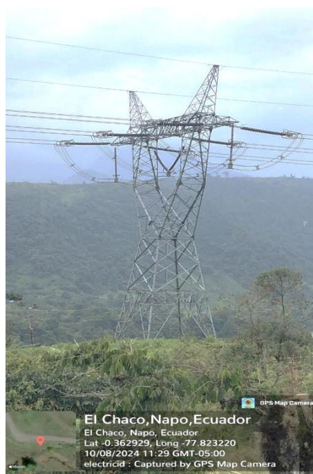
Imagen 3 Torre de Alta Tensión
