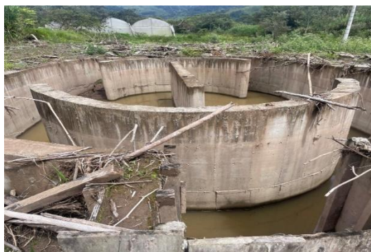
Imagen 28 Planta de tratamiento barrio Central
