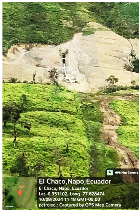
Imagen 4 Tubería de hidrocarburos en la Parroquia Sardinas
